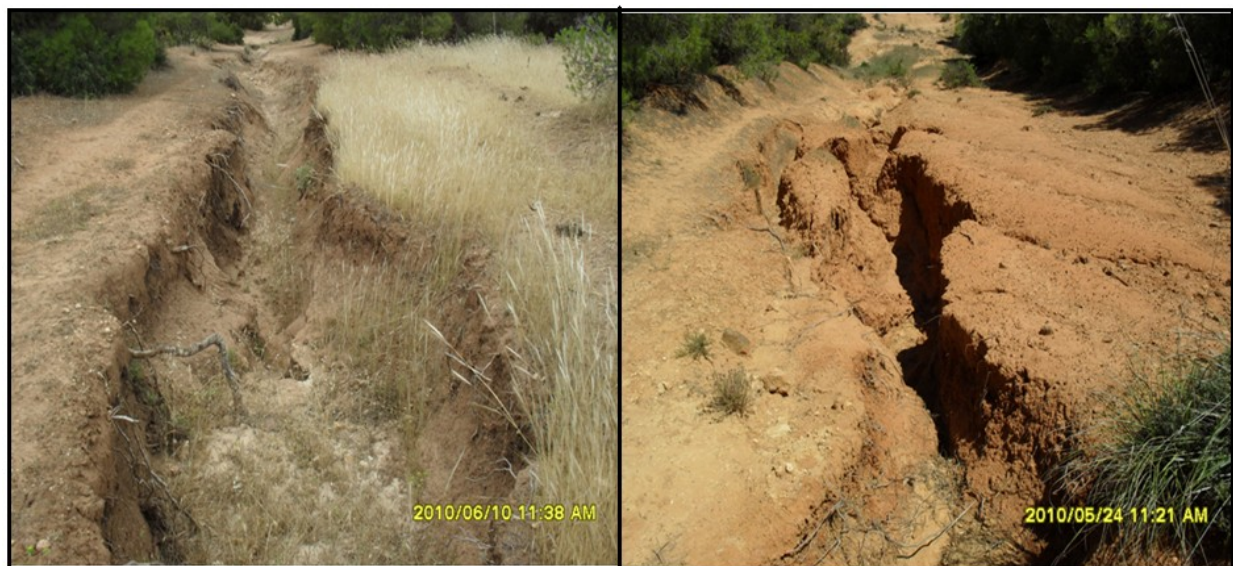
Figure 47: Erosion sur layon (à gauche).
