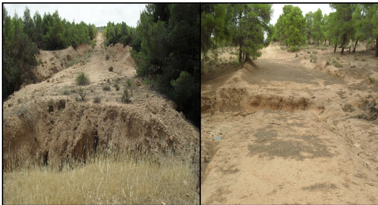
Figure 37 : Plateforme routière coupé par une cour d'eau (à gauche).
