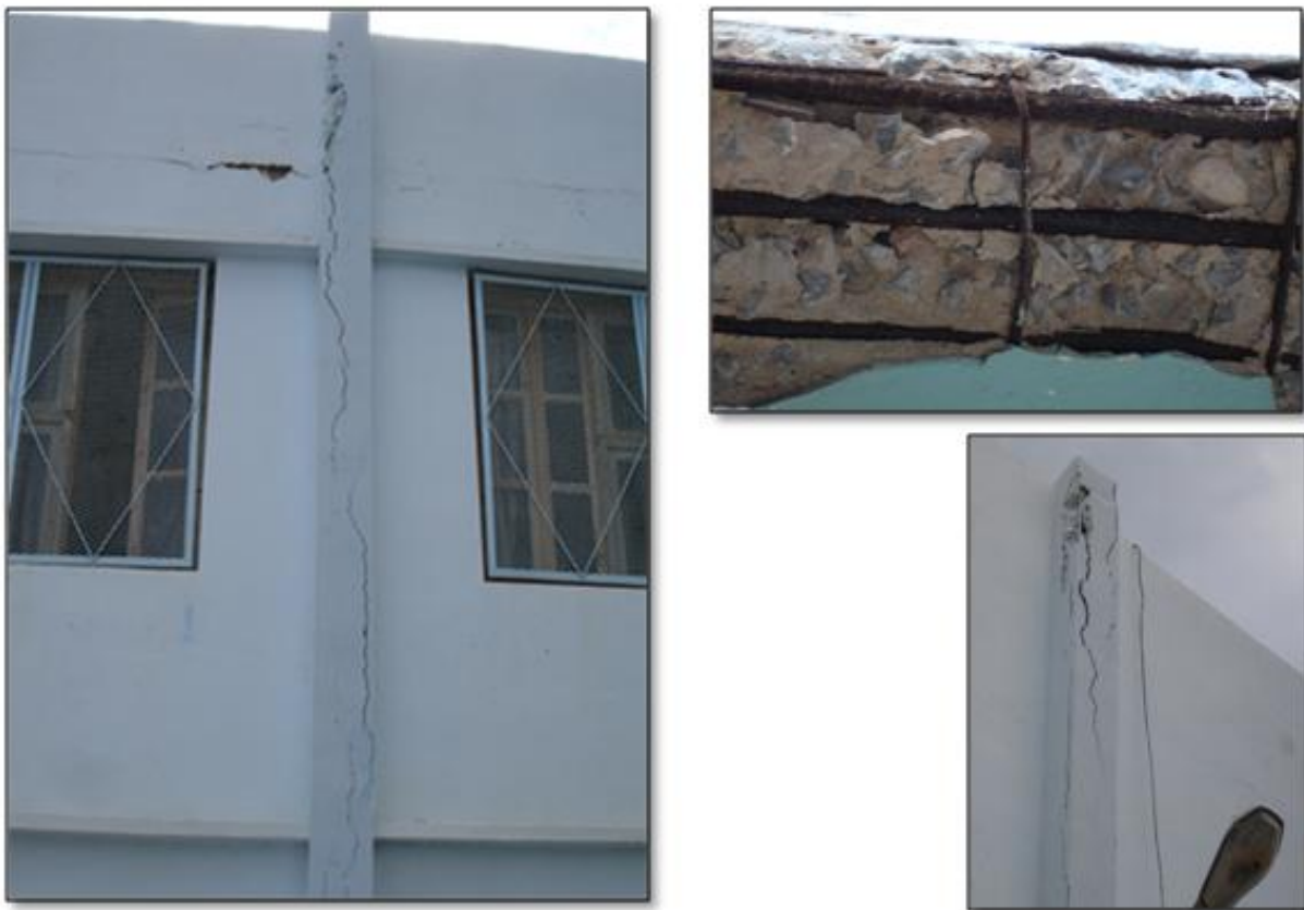
Photo 1. Dégradations constatées au CEM poly-cycle de MARSA BENMHIDI (Photos prises par l'auteur)
