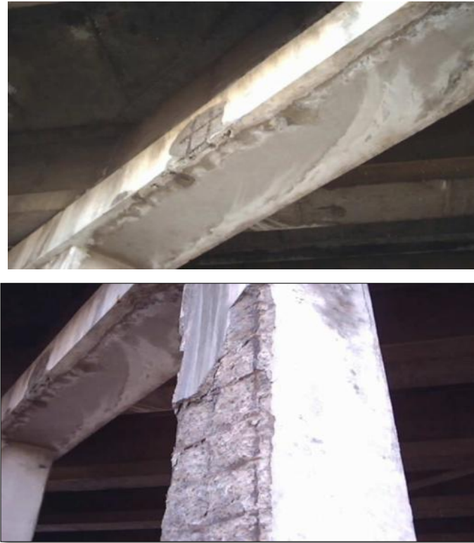
Photo 2. Enrobage en béton insuffisant (front de mer Oran) [LAS, 2008]
