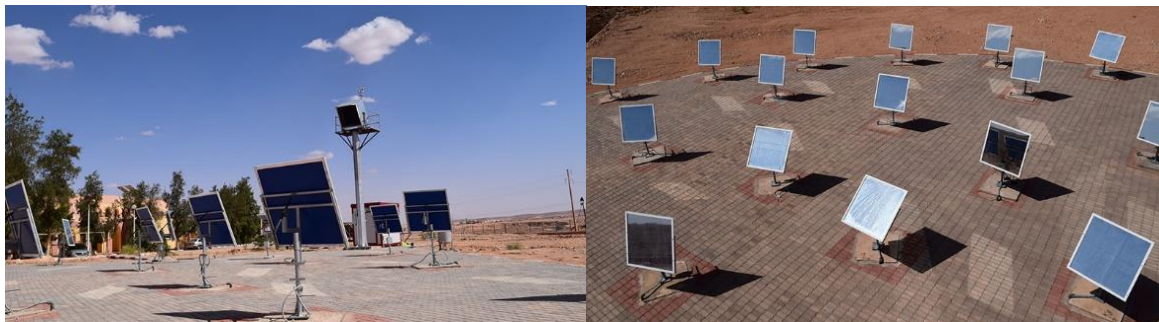
Figure 2.15 – Première mini Tour solaire à concentration en Algérie, Ghardaïa
