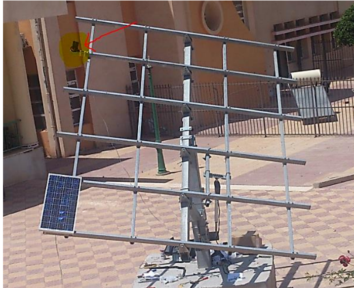
Figure 3.36 – Placement d’un panneau photovoltaïque pour les tests, ainsi que du capteur photosensible (flèche en rouge)
