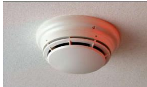
Figure 165:détecteur de fumée
