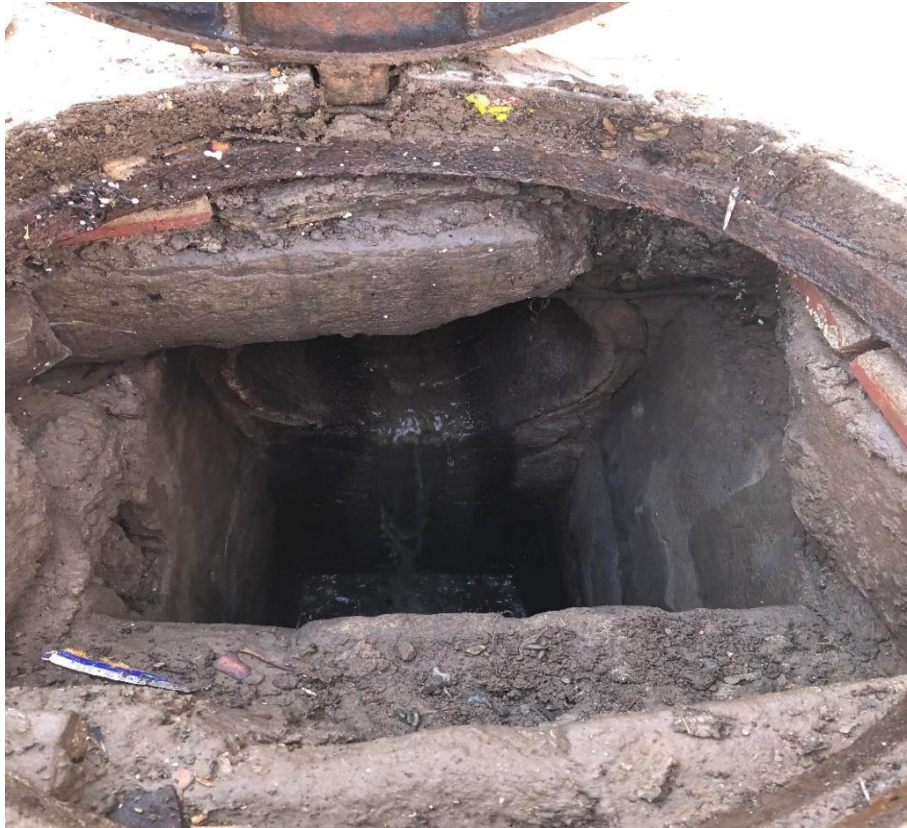
Figure III. 3 : Un regard au cours de service. (Quartier Hartoun).
