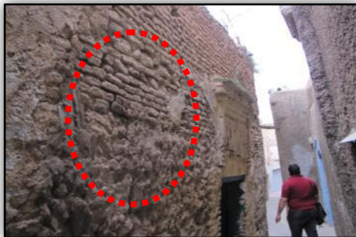
Photo. 41: L'état de dégradation des enduits extérieur des maisons sous l'effet des intempéries et la pousse de végétation.
