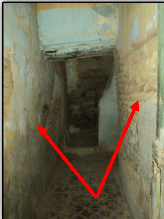
Photo. 73: Dégradation des enduits, Dar El Baroudi . Source : Auteur.
