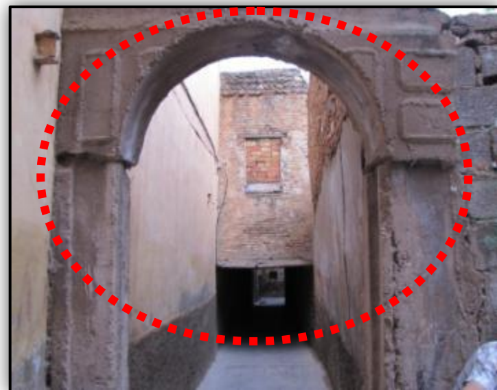
Photo. 43: L'utilisation de matériaux de construction incompatibles aux matériaux d'origine.
