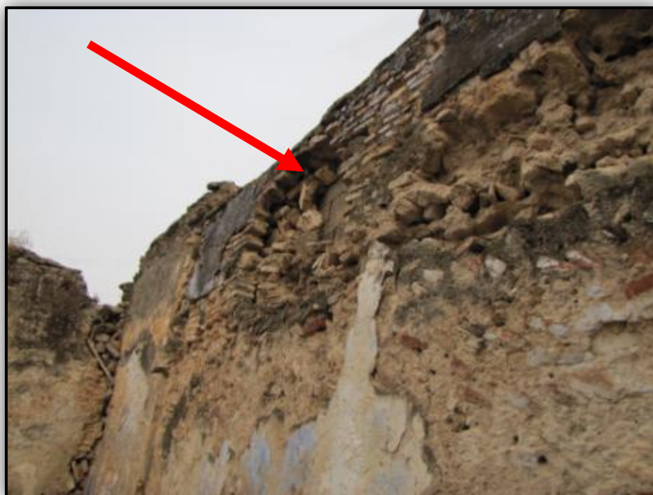
Photo. 67: La disparition et l'effondrement d'une partie de Dar Tchouar . Source : auteur.
