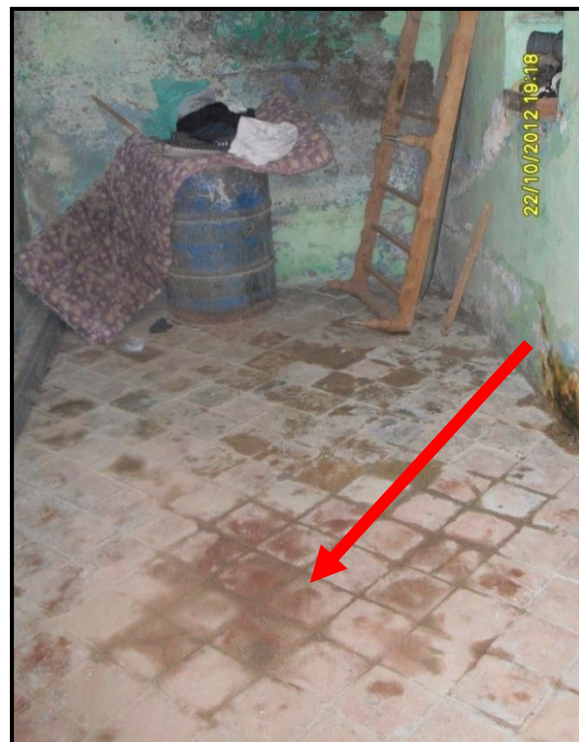
Photo. 60: Détérioration du pavage au niveau du patio et les chambres, de Dar Ben Tabet . Source : Auteur.
