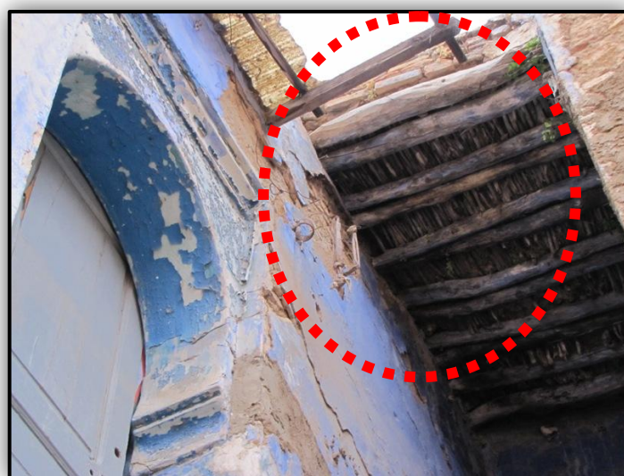
Photo. 42: L'état de dégradation des planchers (voutains, rondins).
