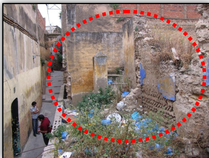
Photo. 44: L'état de dégradation avancée des maisons du quartier (abandonnée, partiellement effondrée et totalement effondrée).
