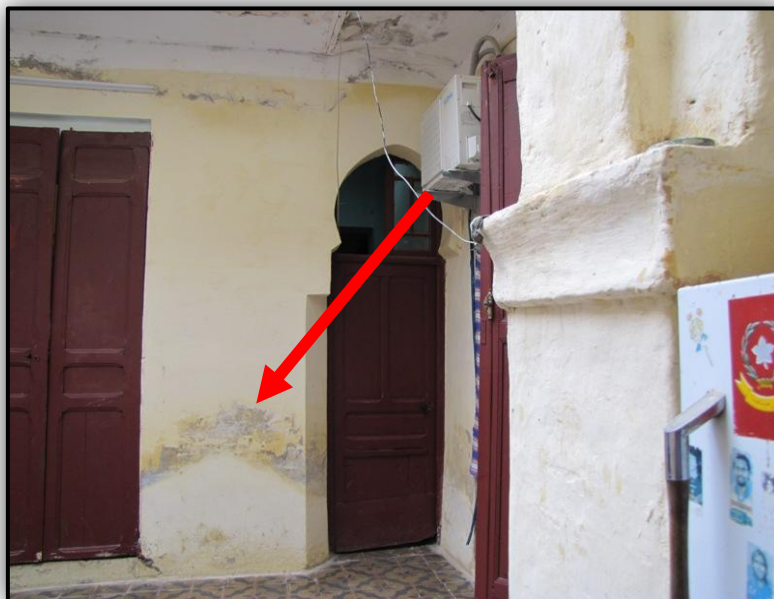
Photo. 48: Traces d'humidité dans les murs intérieurs et extérieurs.
