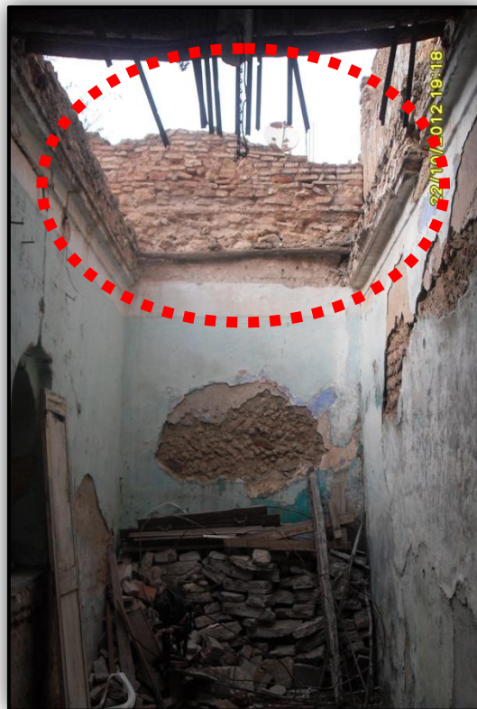
Photo. 57: L'état de dégradation des planchers de la maison et l'effondrement partiel de quelque partie, Dar Ben Tabet, Derb Sensla.
