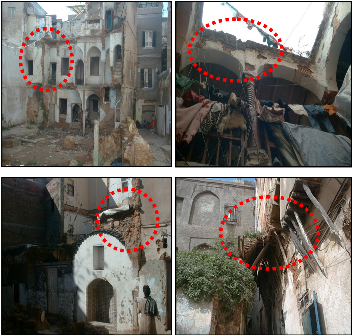
Photo. 29: L'état des maisons du quartier Amar Ali de la Casbah d'Alger. Source : CNERU 2007.
