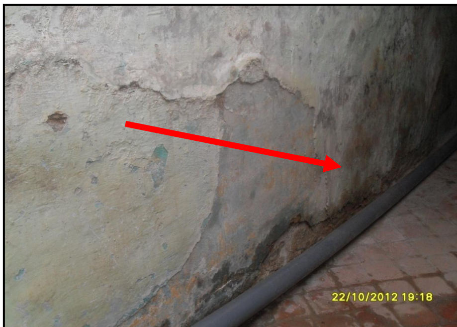
Photo. 59: L'humidité au niveau des murs ainsi qu'au niveau du patio, maison 12, Dar Ben Tabet , Source : Auteur.
