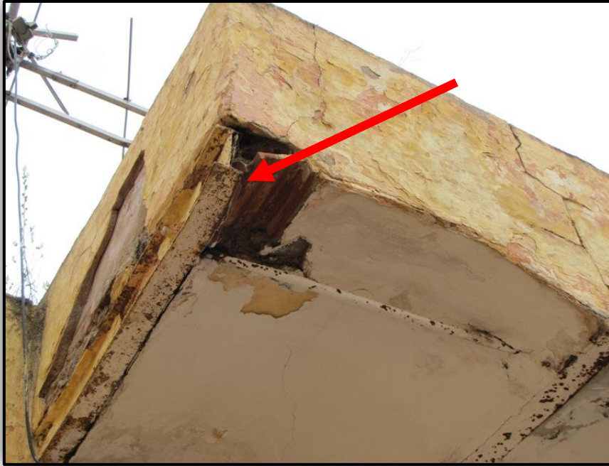
Photo. 50: La corrosion des profilés métalliques qui constituent le plancher de la maison. Source : Auteur.
