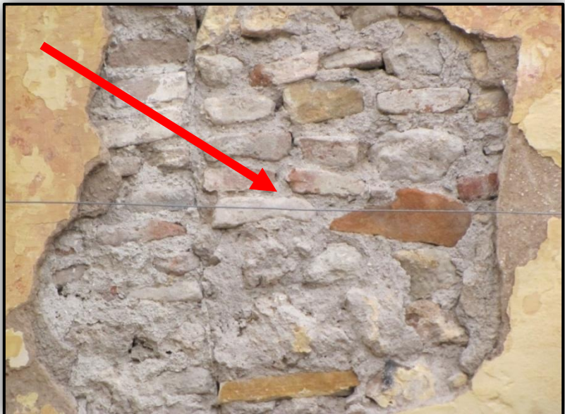
Photo. 49: L'état de dégradation des enduits extérieurs de la maison. Source : Auteur.
