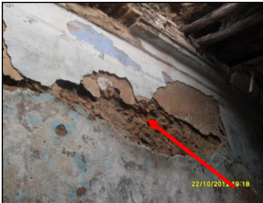
Photo. 58: L'état de dégradation des enduits au niveau maison 12, Dar Ben Tabet, Derb Sensla. Source : Auteur.
