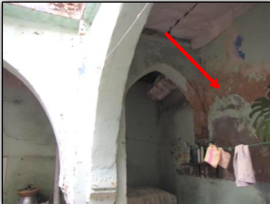
Photo. 65: L'état de dégradation des enduits et les traces d'humidité, Dar Tchouar .
