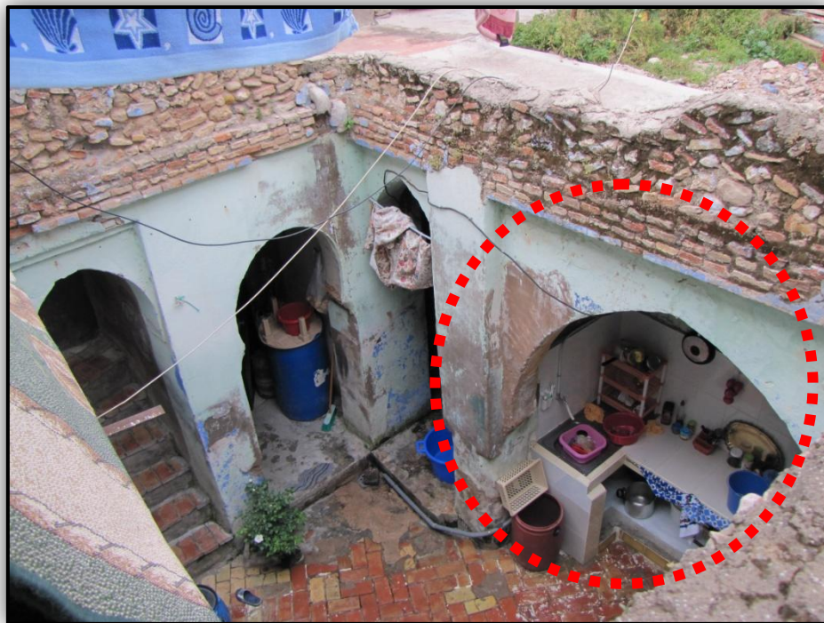
Photo. 66: Rajouts au niveau de Dar Tchouar . Source : Auteur.
