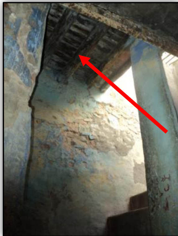
Photo. 72: Dégradation du plancher de Dar El Baroudi . Source : Auteur.
