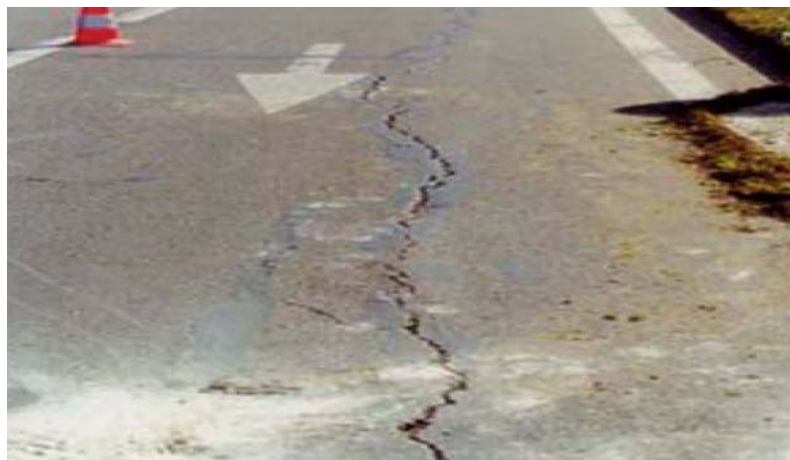
Figure II.14 – Fissuration longitudinale dans une chaussée, attribuée aux effets des cycles d'humidification séchage dans le talus (Ferber et al., 2009).
