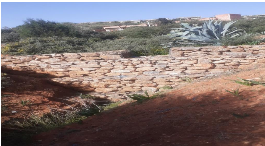
Photo 13 : seuil en gabion stable avec deux cages et un déversoir rectangulaire dans la station d'Ain Merika
