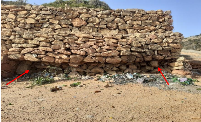
Photo 10 et11 : coupure du grillage métallique induisant au déplacement des pierres et à l'instabilité du seuil en gabion
