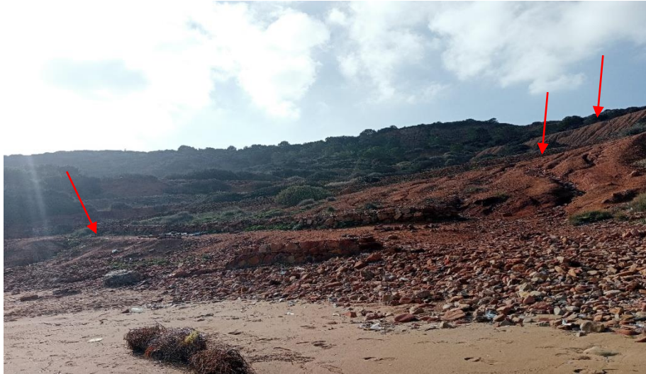
Photo 12 : accélération du phénomène de l'érosion suite à l'instabilité des seuils de gabions
