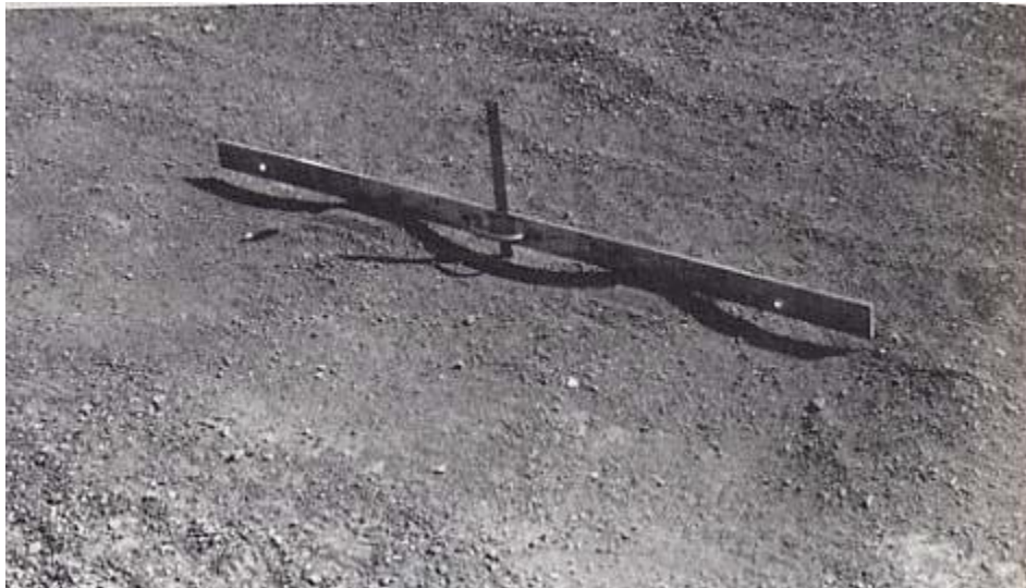
Figure I - 12 : Ondulations lâches avec crête non compactée
