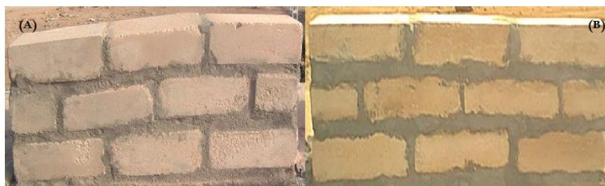
Figure I.22 : murets en BTC après 48mois d'exposition avec deux teneurs en chaux (A) 8% de chaux et (B) 12% de chaux (Guettala2003)
