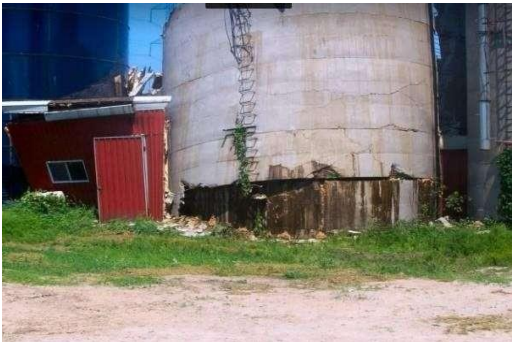
Figure 1.7 : la détérioration des silos-tours en béton par l'attaque des acides [14]. [13]
