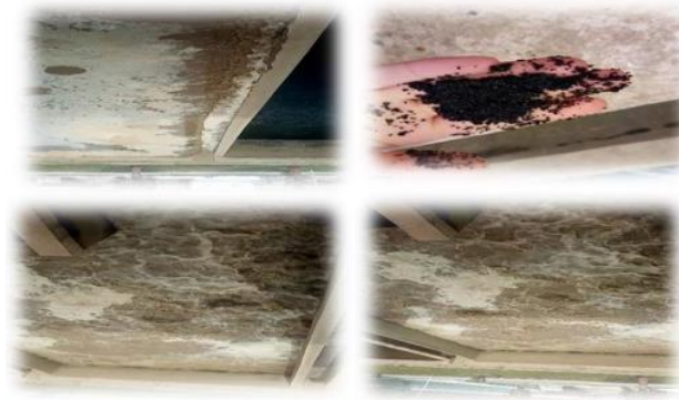
Figure 13 : Bassins de filtrations ( Bedahi, 2022 ).
