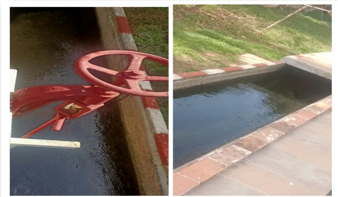
Fig. V.3 : Chambre de captage de la source d'Ain Fouara supérieur
