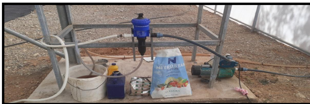
Figure 27: une pompe doseuse (original, 2018)
