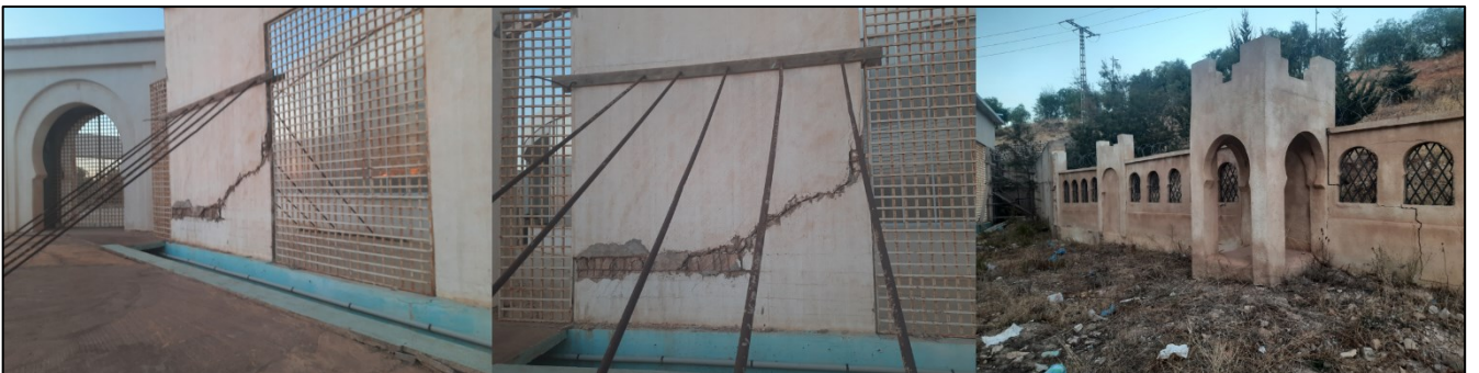
Figure 32 : la dégradation de mur d'enceinte. Source : l'auteur.
