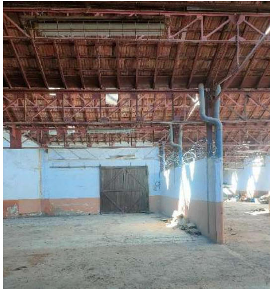
Figure 65 Photo de l'intérieur (tuyauterie, LED et compteur électrique) Source : Auteur
