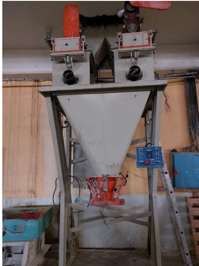
Figure 29 Station balance et conditionnement de la semoule
