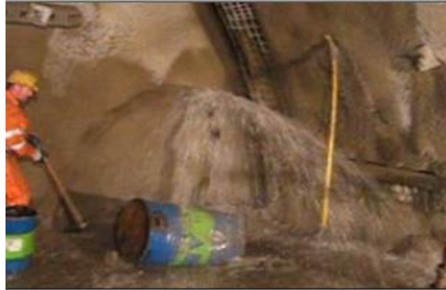
Figure 1.5 Irruption d'eau pendant la construction de la section orientale du tunnel ferroviaire de Wienerwald (ÖBA, 2006)
