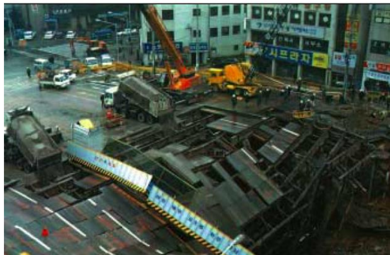
Figure 1.4 Effondrement provoqué par La rupture d'un tunnel en Corée du Sud (El Houari, 2015)
