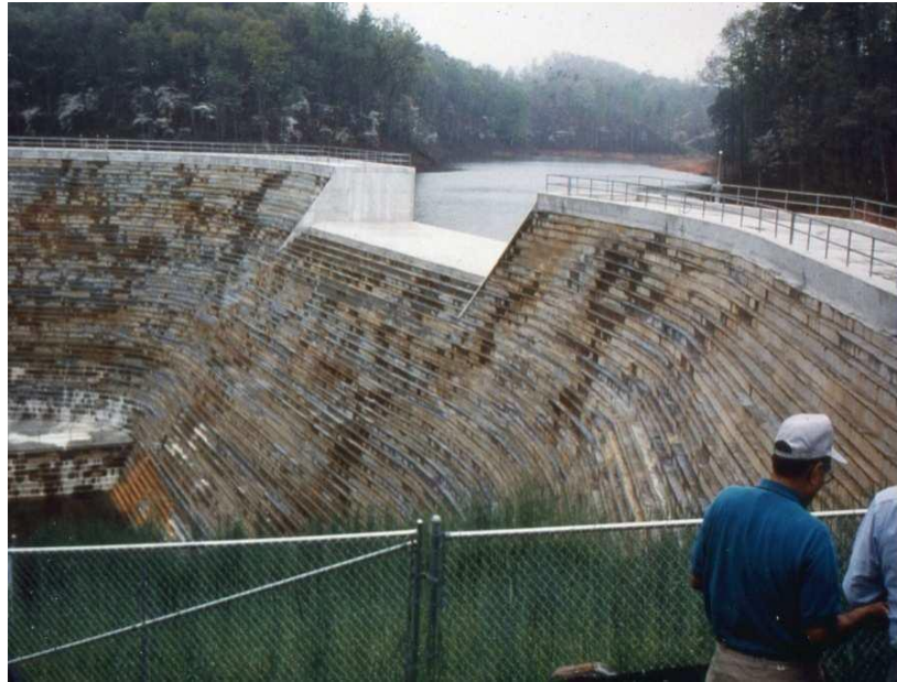
Figure 1. 14 : Fissuration du côté Aval du barrage Hudson [34].
