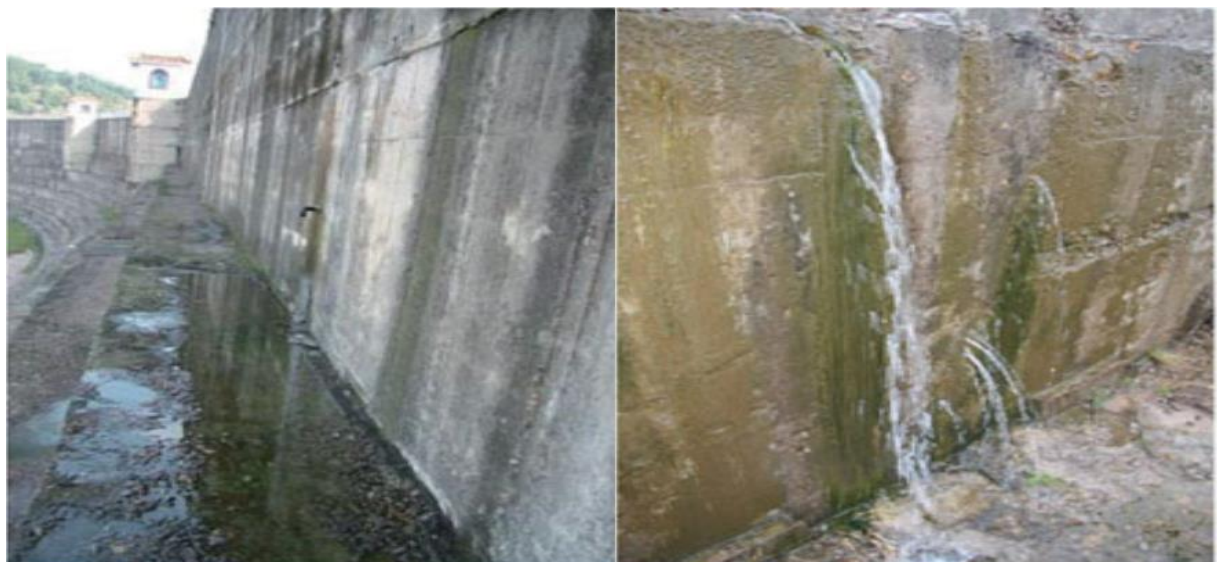
Figure 1. 13 : Des problèmes de fuites provenant des fissures au niveau les blocs 7 et 8 [36].
