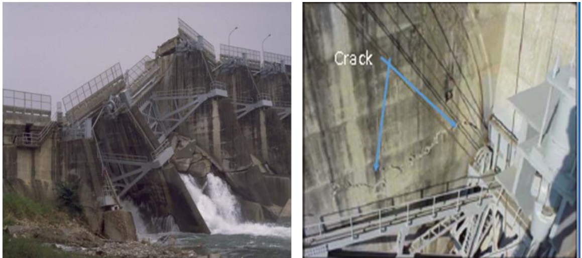
Figure 1. 16 : Défaillance du barrage Shih Kang à cause du déplacement vertical durant le séisme de ChiChi 1991 avec une magnitude de 7.62 [44,46].
