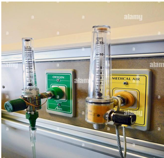
Figure 11 : Les panneaux de tête de lit d'hôpital, pour l'oxygène et l'air médical [59]
