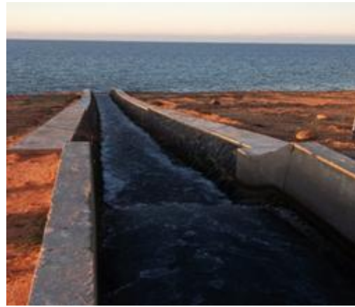
Fig62 : Evacuation des eaux d'élévation par le canal des rejets
