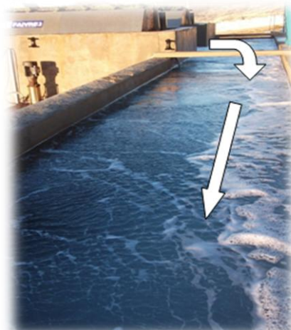
Fig56 : Cheminement de l'eau de mer pompée dans le canal d'alimentation principal
