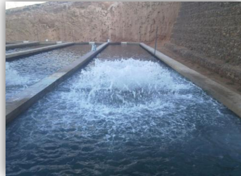
Fig65 : Aérateur en marche
