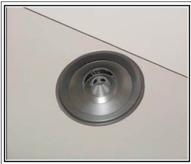
Fig113 : Bouches de Soufflage
