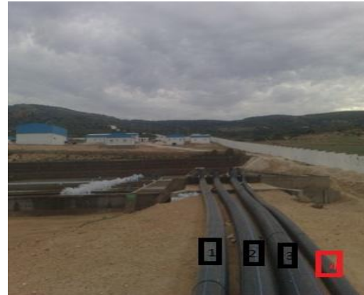
Fig54 : Prolongement des conduites de la station de pompage de la ferme "Aqua Sole"
