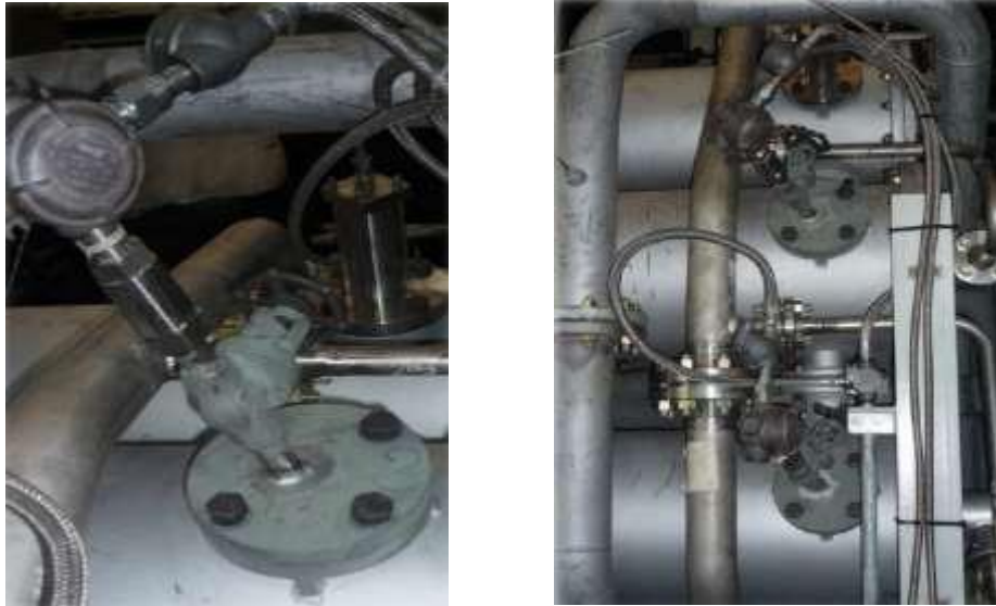
Figure III.10. Détecteurs de flamme.
