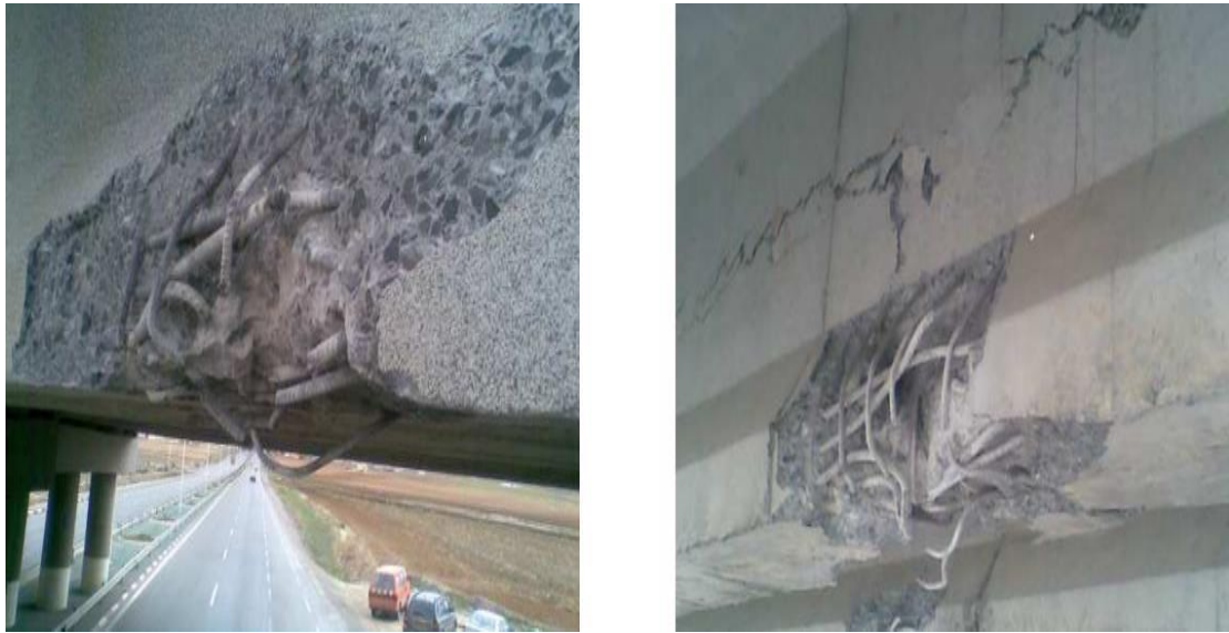
Figure II- 1: Dégradations causées par le choc
