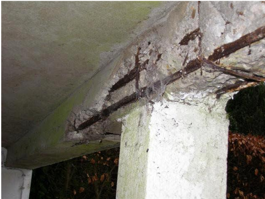
Figure II- 8: Corrosion des armatures dans les structures en béton armé
