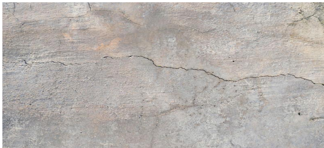
Figure II- 2: Effet du Ressuage du béton
