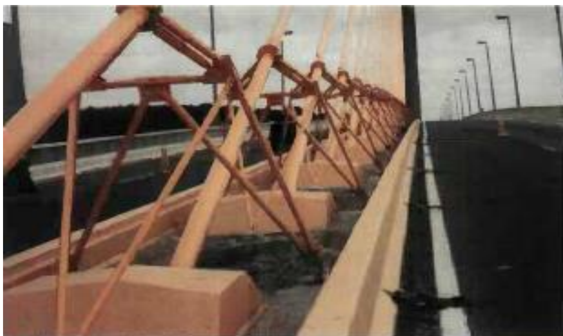
Figure I- 31: Amortisseurs du pont de Brotonne
