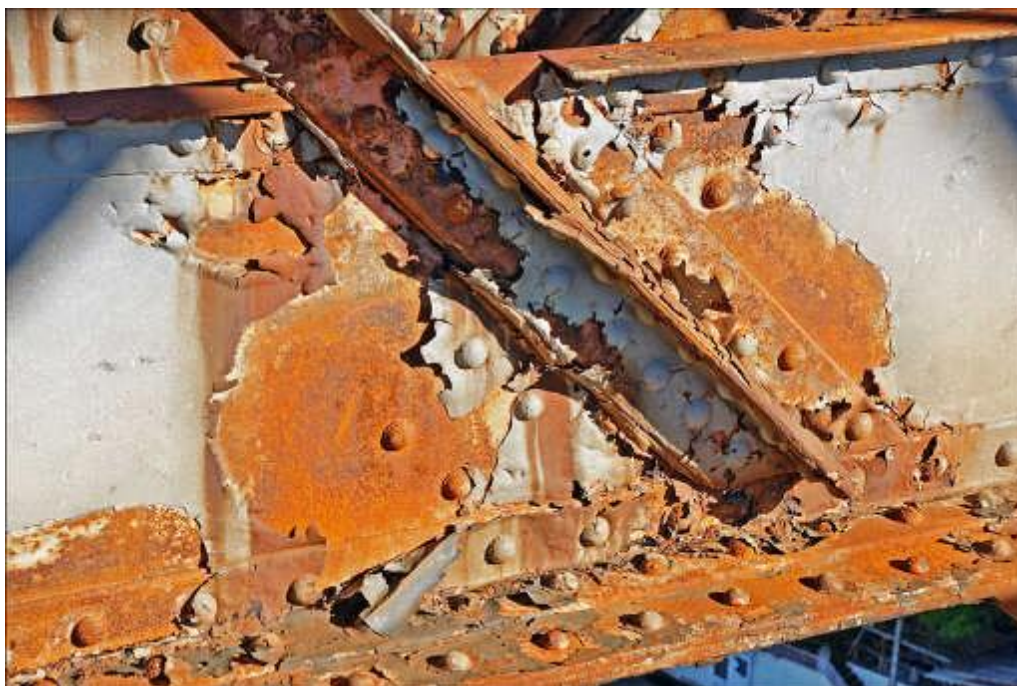
Figure II- 7:Corrosion atmosphérique des ouvrages
