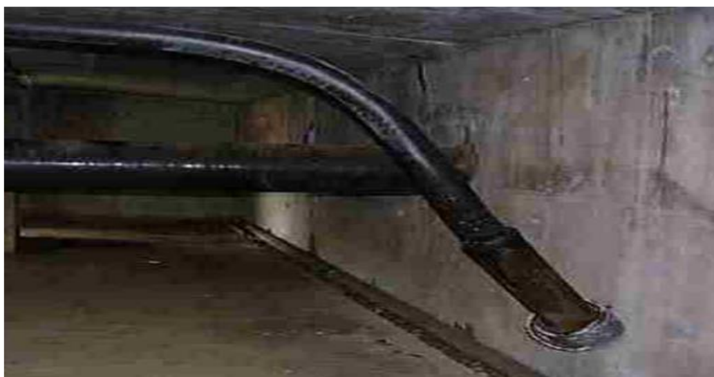
Figure II- 4:Rupture du câble par corrosion
