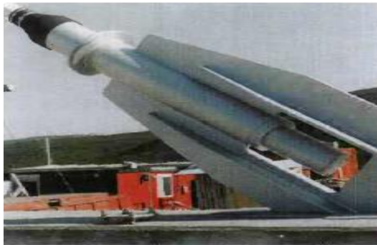
Figure I- 27: Ancrage bas d'un hauban sur le pont Utsjoki en Finlande - pièce de liaison fixe
