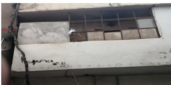
Figure 56 : habitat mauvais état source : prise par auteur
