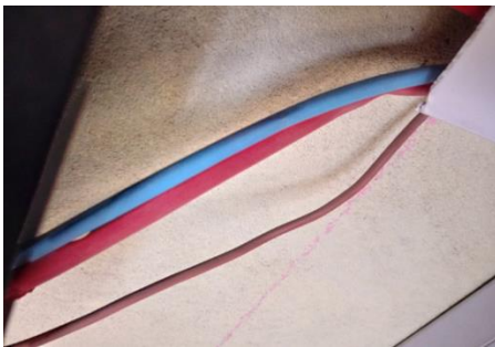
Figure 2.9 : Câbles non fixés
