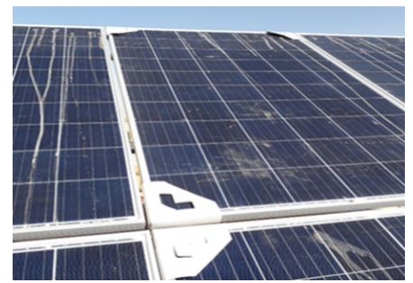
Figure 2.11 : Salissure des panneaux photovoltaïque (pollution, sable)
