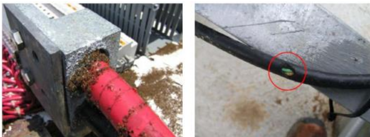
Figure 2.13 Exemples de défauts rencontrés dans le système de câblage.
