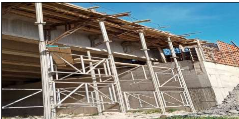
Figure 60: étalement de portafons
