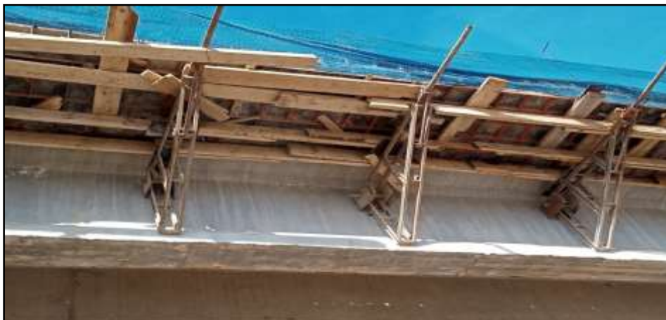
Figure 59: Étalement de portafons
