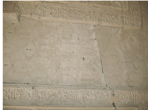
Stuc altéré ( des fissures
