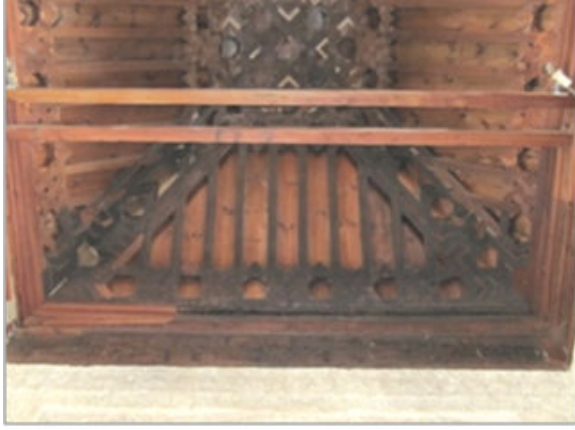
Partie du plafond épargnées par l'incendie.
