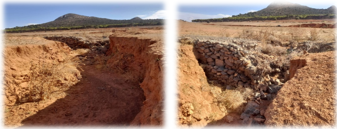
Photos 17 et 18 : seuil en gabion instable à cause d'un mauvais ancrage et une mauvaise fondation (Cliché BELAMOURI, Septembre 2022)
