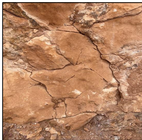
Fig. 14 : Présence des fractures et des fissures multidirectionnelles dans le quatrième gradin.
