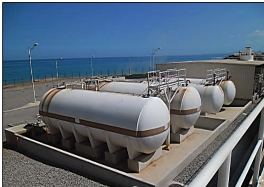
Figure 14 : Réservoirs des produits chimiques.
