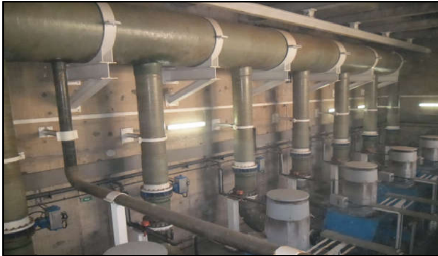
Figure 13 : Station de pompage d'eau brute.
