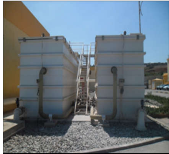
Figure 21 : Saturateur de chaux.
