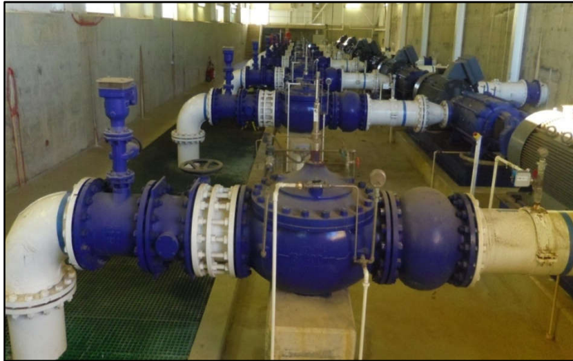
Figure 23 : Station de pompage de l'eau traitée.
