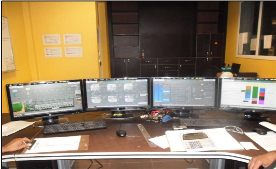
Figure 25 : Salle de contrôle.
