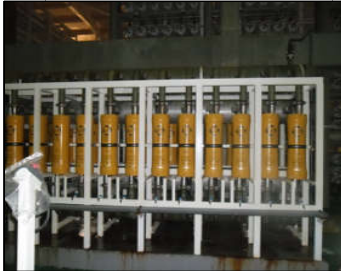
Figure19 : Système de récupération d'Énergie.
