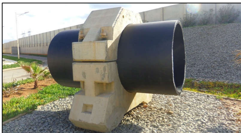
Figure 12 : Conduite en PEHD fixé par une tête en béton.
