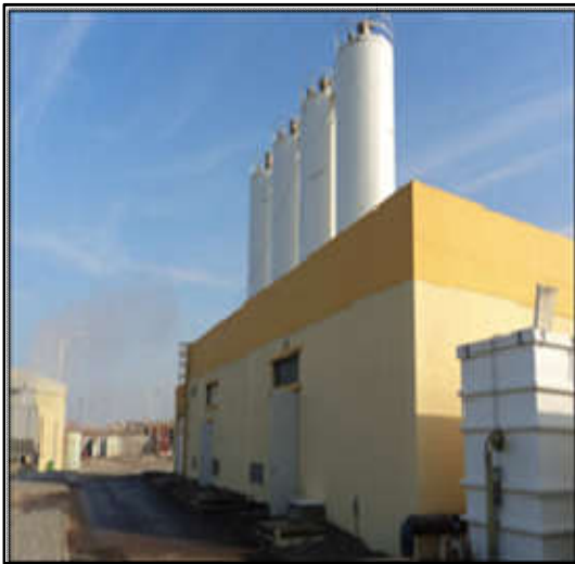
Figure 20 : Silos de chaux.
