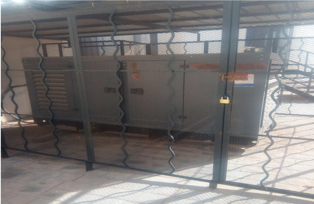
Figure 44 Proue électrogène d'une puissance apparente de 100KVA
