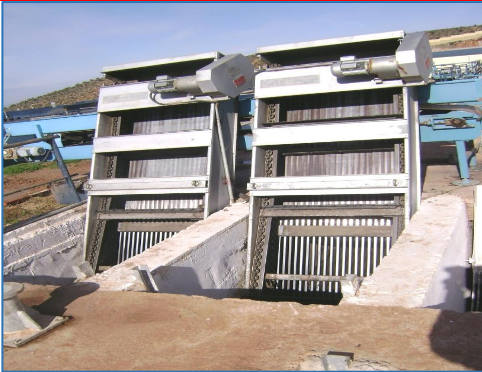
Photo N°03 : Grille mécanisée (2 unités)(ONA)
