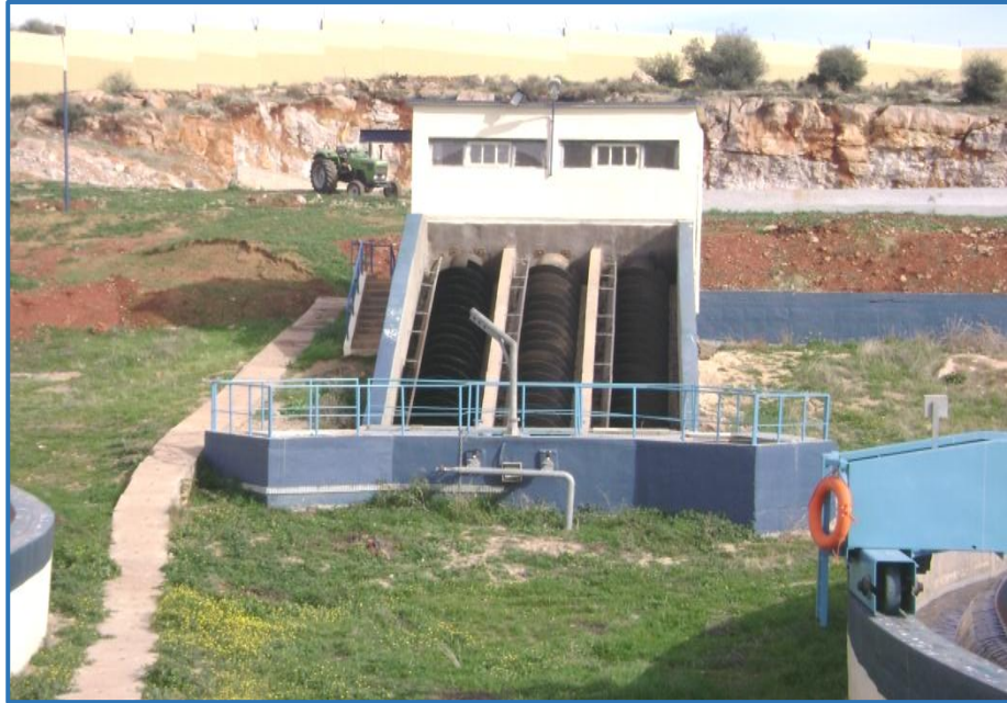
Photo N°08: Vis de recirculation(ONA)
