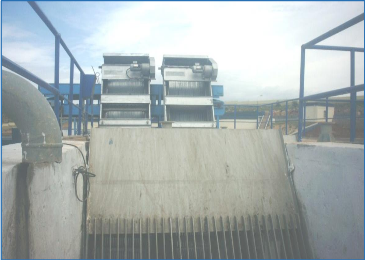
Photo N°02 : Grille grossière manuelle (1 unité)(ONA)
