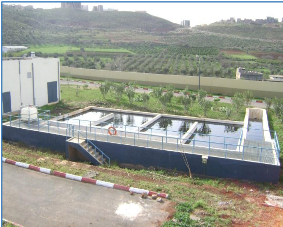
Photos N°07 : Canal déversoir du rejet du bassin de chloration(ONA)
