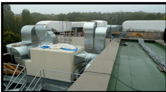
Figure III.26 : la CTA positionnée en toiture 83
