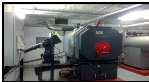
Figure III.27 : la chaudière bois avec son alimentation 84
