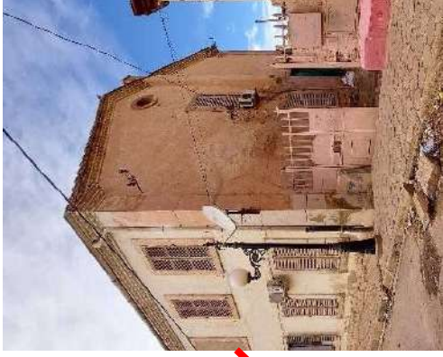
Habitat individuelle en mauvais état
