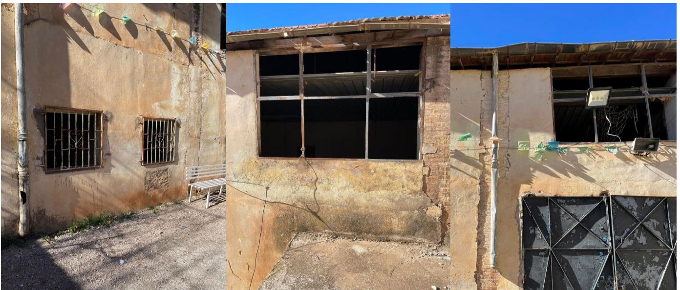
Photo 15 : Les fenêtres cassées.
