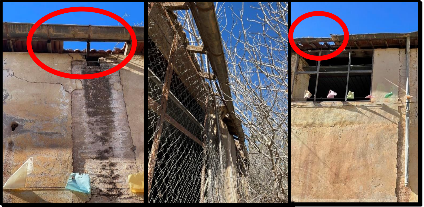
Photo 16 : Evacuation des eaux pluviales.
