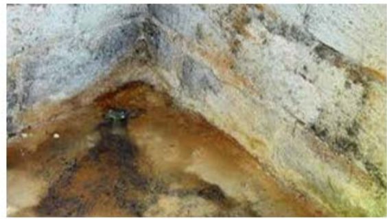
Apparition de moisissures
