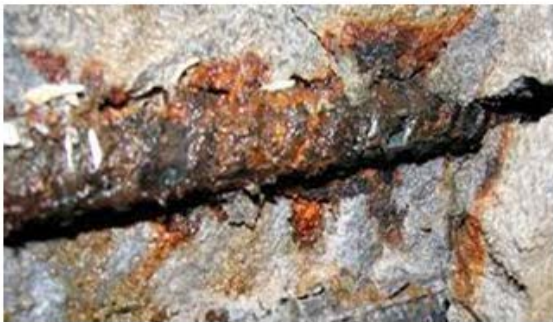
Corrosions des aciers
