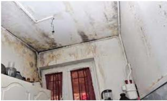
Détérioration du plafond
