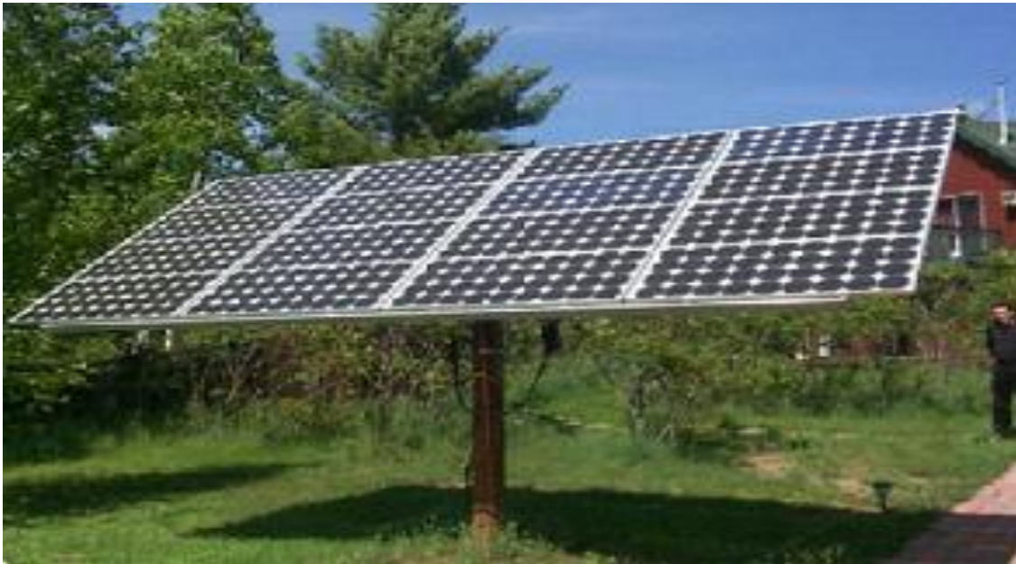
Figure II-1 : Système photovoltaïque à inclinaison fixe. Avec la permission de Bill Kemp[30]
