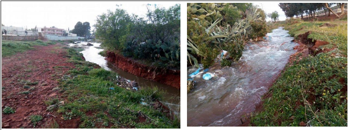
Figure III.7 : Tracée de l'oued nécessite un recalibrage (19/04/2016)
