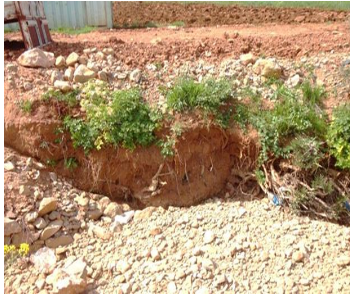
Figure III.2 : L'érosion des berges d'oued causant des dépôts de sédiments (06/02/2016)
