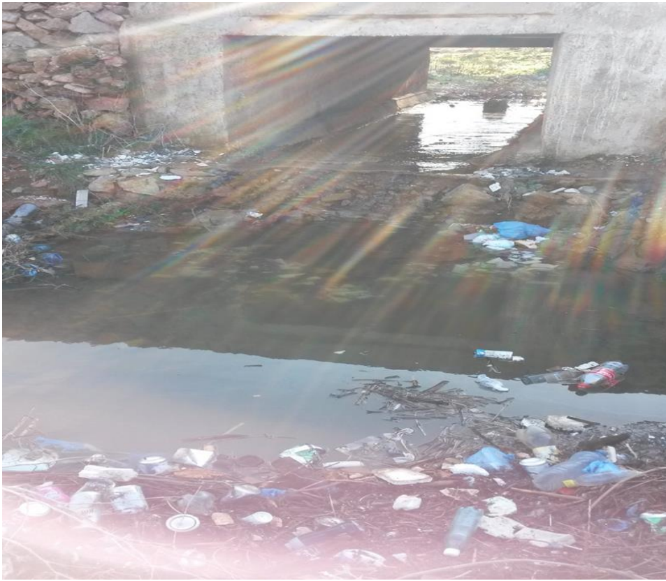
Figure III.4 : Inondation de terre au niveau de traversée de route (19/04/2016)
