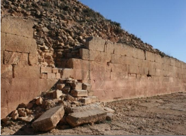
الصورة رقم 86: سقوط جزء من جدار الواجهة الجنوبية - المدخل
