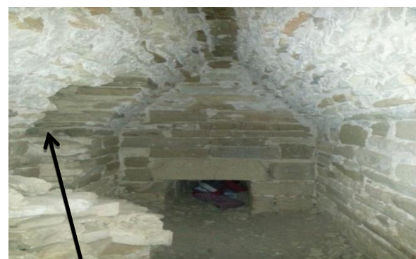
الصورة رقم 233: الغرفة عشرون جزء من الجدار مهدم
