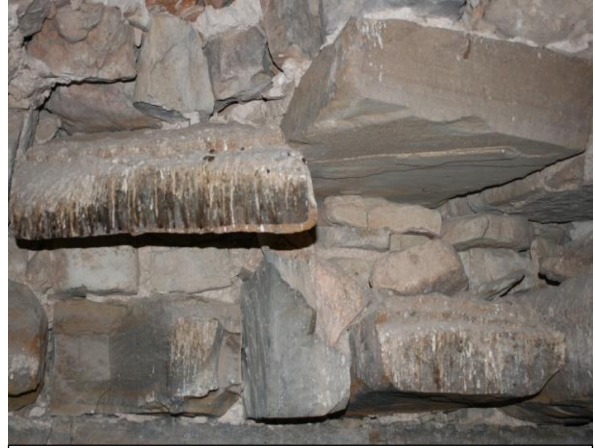
الصورة رقم 85: سقوط جزء من سقف المدخل
