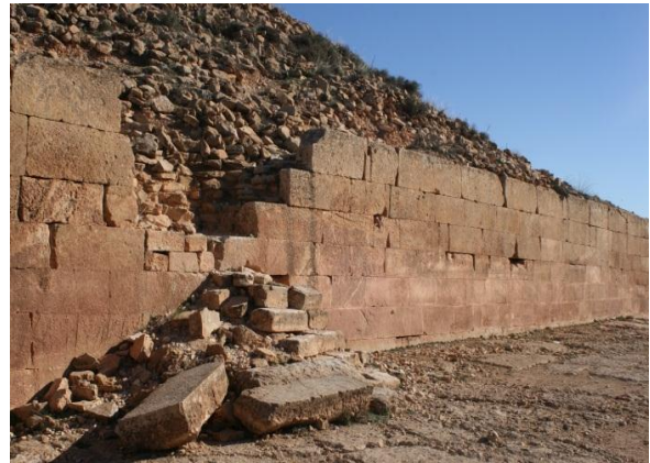
الصورة 49: المدخل الجديد الذي يشكل خطرا على المعلم
