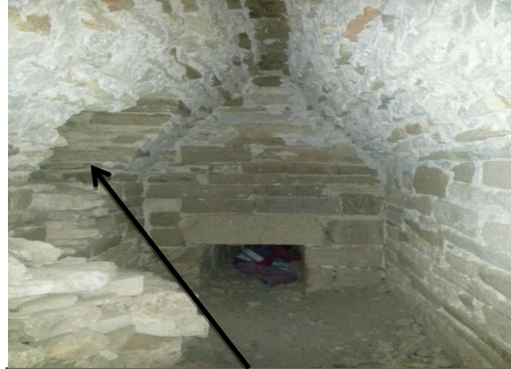
الصورة رقم 76: سقوط جزء من جدار الغرفة التاسعة عشر
