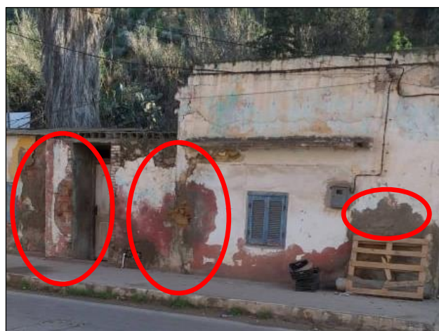
Figure 57. Habitation en état de dégradation
