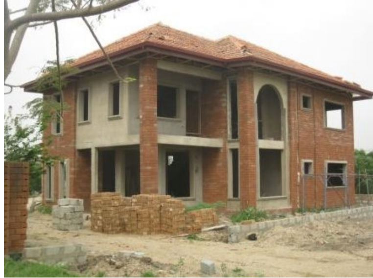
Figure 1.10 : Une construction en BTC Abidjan, Côte d'Ivoire.
