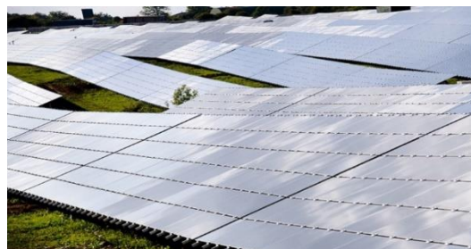
Figure22 : Exemple de panneaux solaires Source( https://www.edf.fr/groupe-edf/espaces-dedies/l-energie-de-a-a-z/tout-sur-l-energie/produire-de-l-electricite/qu-est-ce-que-l-energie-solaire#:~:text=L%C3%A9nergie%20solaire%20est%20une,capt%C3%A9%20par%20des%20panneaux%20solaires. )
