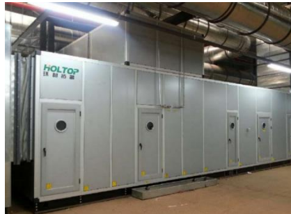
Figure 141. UTA (Unité de traitement d'air)
