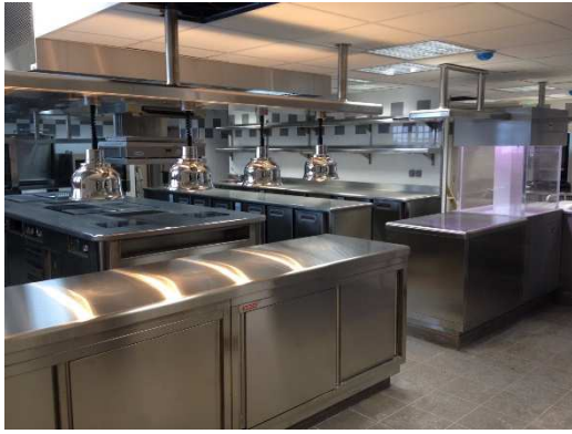
Figure 158: exemple de cuisine d'hotel source : http://www.cuisine-professionnelle-maroc.com/hotels-materiel-et-equipement-de-cuisin
