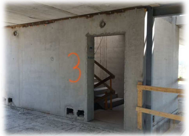
Figure 64: mise en place des cages d'escalier préfabriquées avec des connexions de l'entreprise
