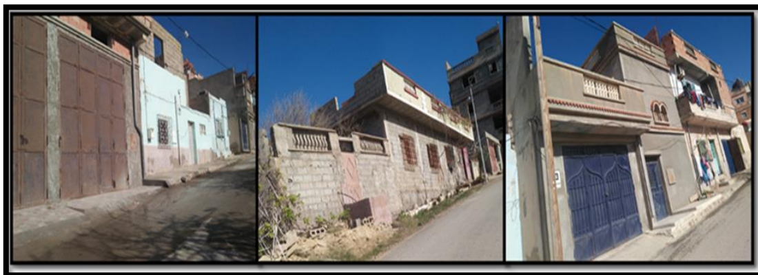
Fig III . 12 Etat de la façade
