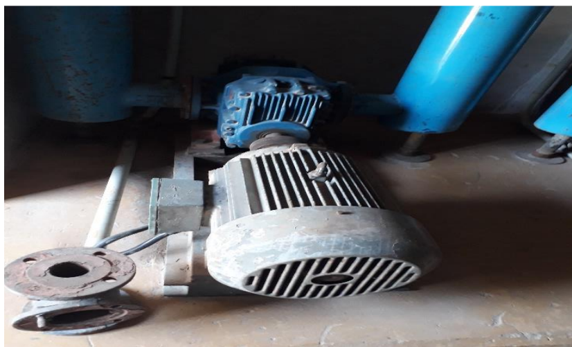
Figure (II.10) : Le compresseur fonctionné.
