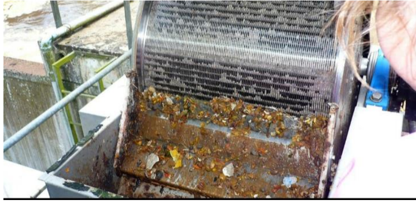
Figure (I.5) : Dégrilleur des eaux usées [11]
