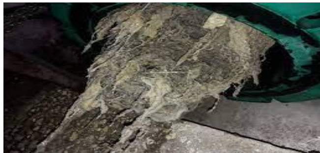
Figure (I.15) : Canalisation bouchée
