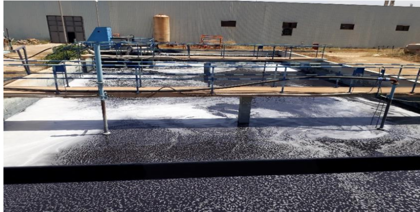
Figure (II.3) : Bassin de mélange et d'égalisation N°1.
