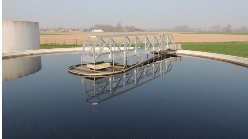
Figure (I.13) : Un clarificateur
