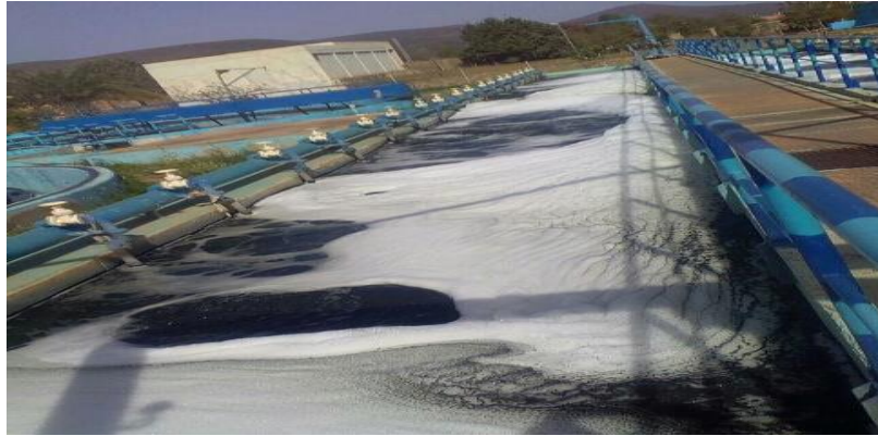
Figure (II.9) : Bassin de traitement biologique.
