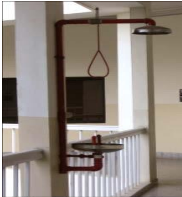
Figure 11 : Douche de sécurité et le bassin oculaire installés comme une seule et même unité
