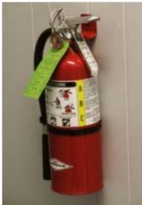
Figure 12 : Photo d'un extincteur type ABC
