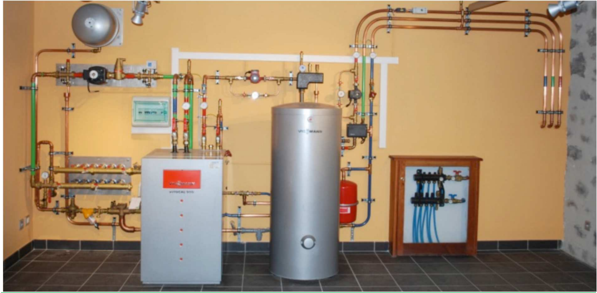
Figure (1.6) : l'installation d'une pompe à chaleur [6]
