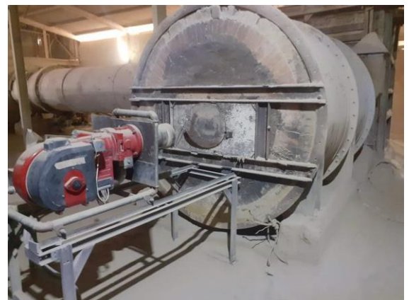
Fig. 17- Chambre de combustion
